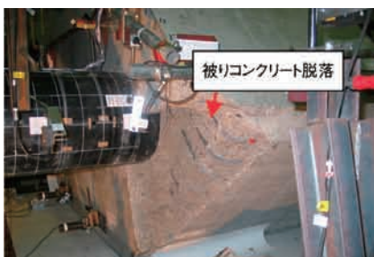
写真3 フーチング被りコンクリート脱落
