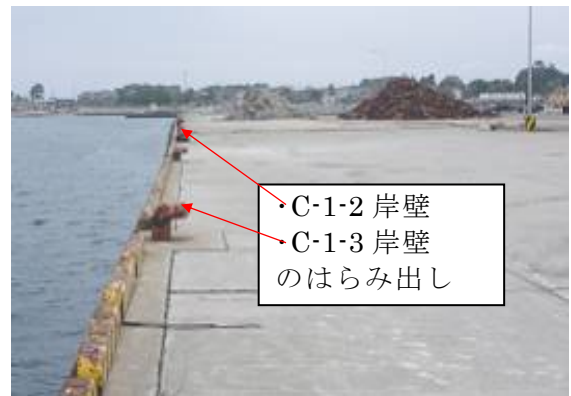
写真 4.3.4 C-1-4 から見た両岸壁のはらみ出し
