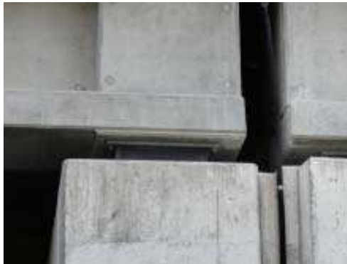
写真 2.1.4 支承部の変形
