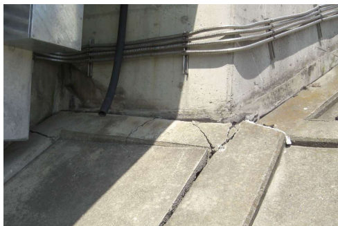
写真 2.1.5 堤防法面のひび割れ
