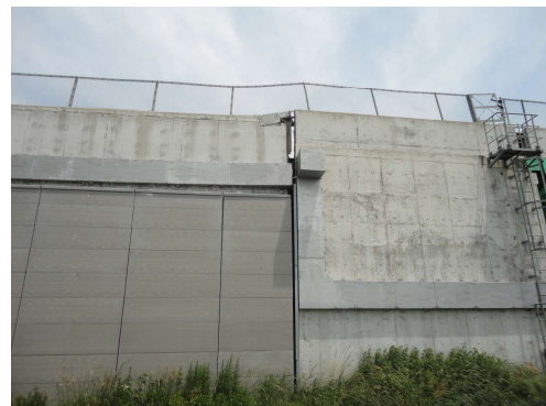
写真 2.1.6 桁端部でのずれ
