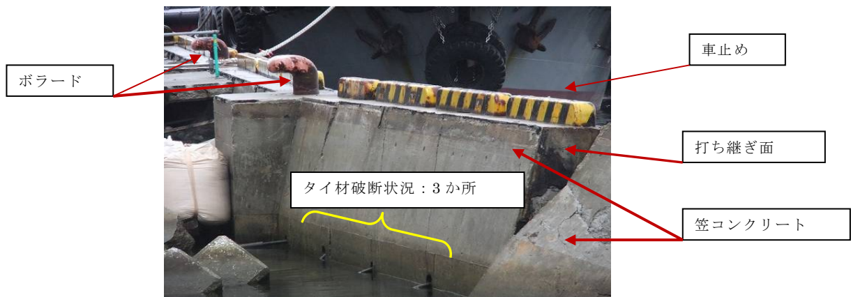
写真 4.3.5 タイブルの破断部例
