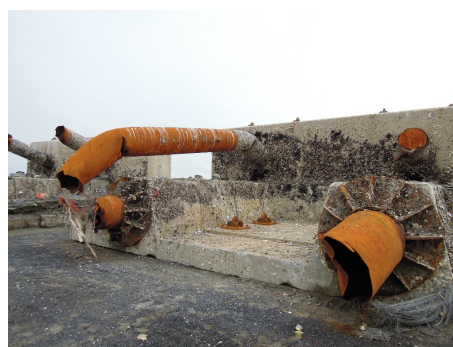
写真 4.1.2 石巻漁港波除堤の被災状況
