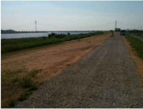
詳細写真2 (地点④、止水矢板区間、応急復旧済)
