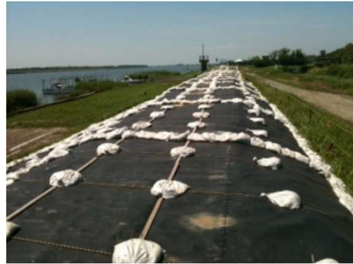
詳細写真10 (地点⑧、止水矢板区間、応急復旧済)
