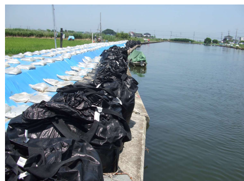
写真 3.4.6 横利根川 (鋼矢板のはらみ出し)
