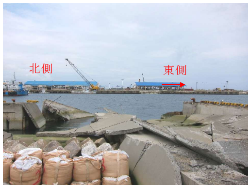
写真 3.3.17 相馬港の被災状況(2) (隅角部の破損・洗掘)
