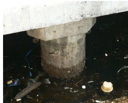
写真 3.2.7 久慈漁港の被災状況(3) (FRPカバーの脱落)
