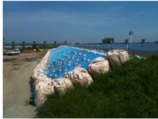
詳細写真9 (地点⑦、無対策箇所、応急復旧済)
