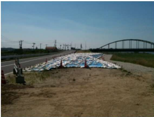
詳細写真8 (地点⑥、無対策箇所、応急復旧済)
