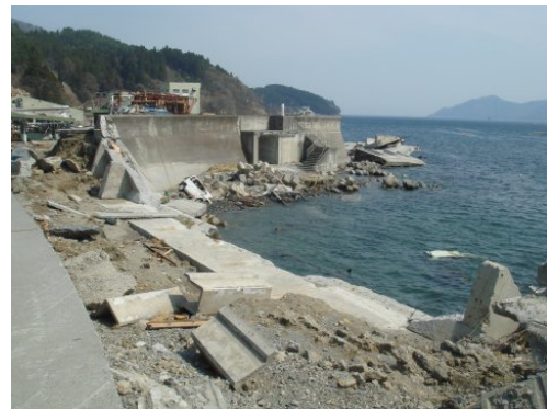
写真 3.3.2 大船渡市三陸町の 防潮堤被害
