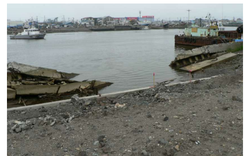
写真 3.2.14 八戸港 川目の被災状況 (控え式鋼矢板の前傾・背面陥没)
