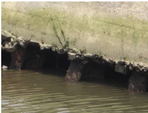
写真 3.3.31 那珂湊漁港の被災状況(4) (岸壁 陸側の拡大写真、H 形鋼)
