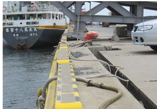
写真 3.3.25 小名浜港の被災状況(4) (第5埠頭、ケーソンのはらみ出し)
