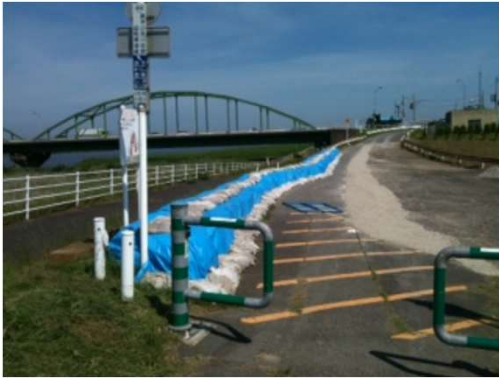
詳細写真7 (地点⑥、無対策箇所、応急復旧済)
