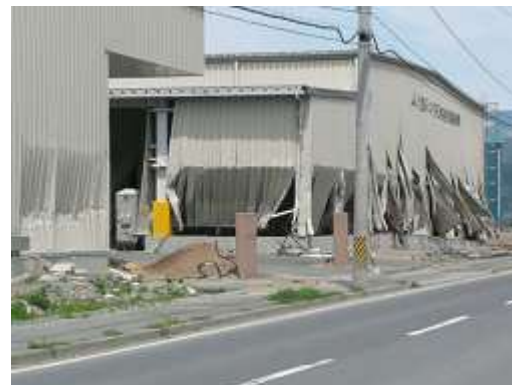
写真 3.2.13 近接構造物の被害状況
