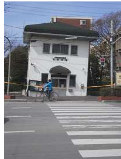
写真 3.2.7 液状化による被害⑥ (建物の沈下と傾斜：浦安市富岡)
