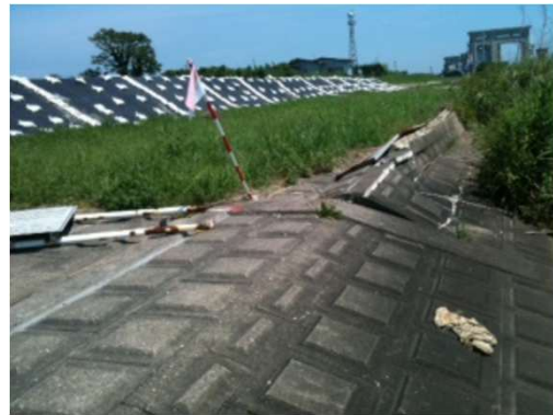
詳細写真11 (地点⑧、止水矢板区間、ブロック損傷)
