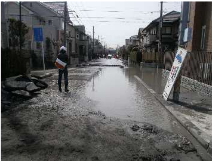
写真 3.2.6 液状化による被害⑤ (噴砂と水道管の破断：浦安市舞浜)
