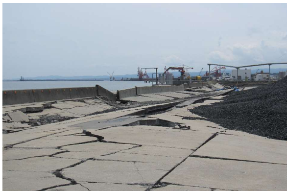
写真 3.3.23 小名浜港の被災状況(2) (第3埠頭、パラペット部・コンクリート舗装の被災)
