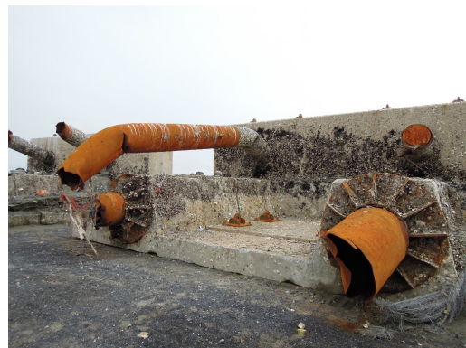
写真 3.3.19 石巻漁港波除堤の破断状況
