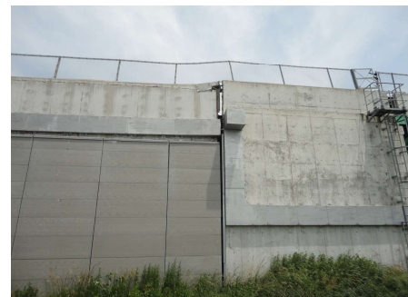
写真 3.1.6 桁端部でのずれ
