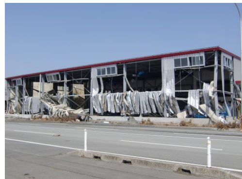
写真 3.3.4 石巻漁港の工場被害
