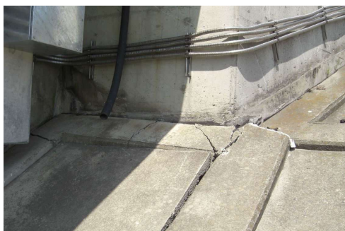
写真 3.1.5 堤防法面のひび割れ
