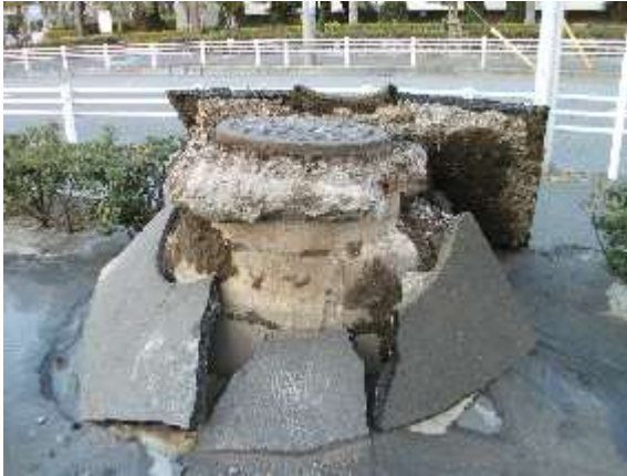
写真 3.2.4 液状化による被害③ (噴砂とマンホールの浮上り：浦安市高洲)
