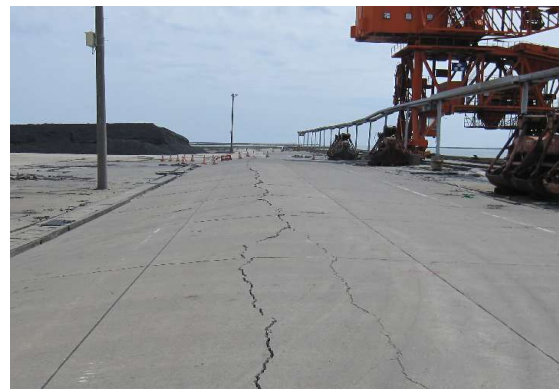
写真 3.3.24 小名浜港の被災状況(3) (第3埠頭、エプロンの沈下)
