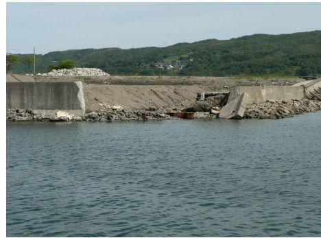
写真 3.3.5 久慈漁港の被災状況(1) (鋼矢板護岸 隅角部)
