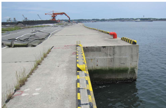
写真 3.3.26 小名浜港の被災状況(5) (第5、6埠頭、ケーソンの移動)
