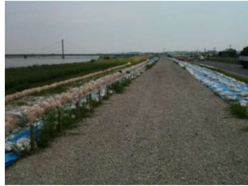
詳細写真4 (地点①、無対策箇所、応急復旧済)
