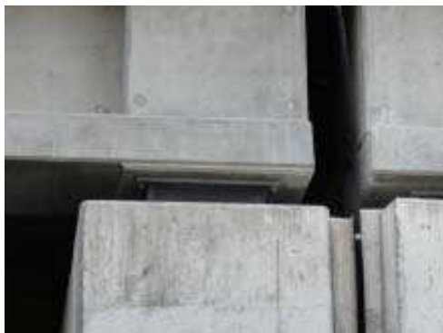
写真 3.1.4 支承部の変形
