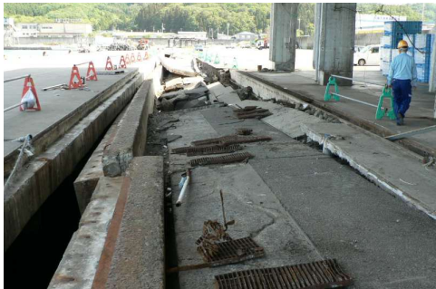
写真 3.3.6 久慈漁港の被災状況(2) (渡版落下・背面陥没)
