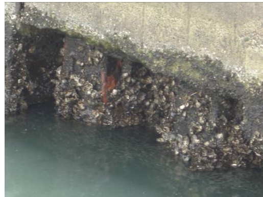
写真 3.3.32 那珂湊漁港の被災状況(5) (岸壁 海側の拡大写真、鋼矢板)
