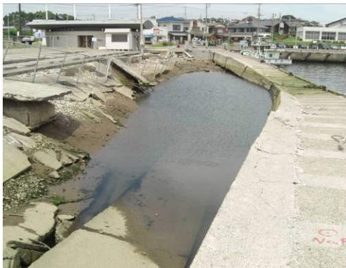
写真 3.3.29 那珂湊漁港の被災状況(2) (岸壁はらみ出し、裏込め部洗い出し)
