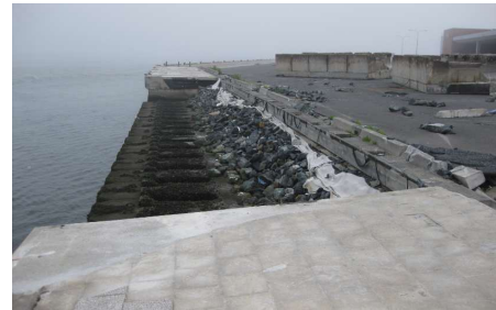
写真 3.2.12 築港街第一埠頭の被災状況 (消波型 RC 堤の上部ブロック飛散)
