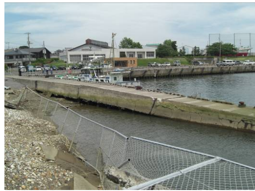
写真 3.3.30 那珂湊漁港の被災状況(3) (岸壁の傾斜)
