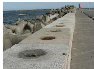
写真 3.3.9 八木港の被災・応急復旧状況 (上部ブロックの飛散・RCブロックによる復旧)
