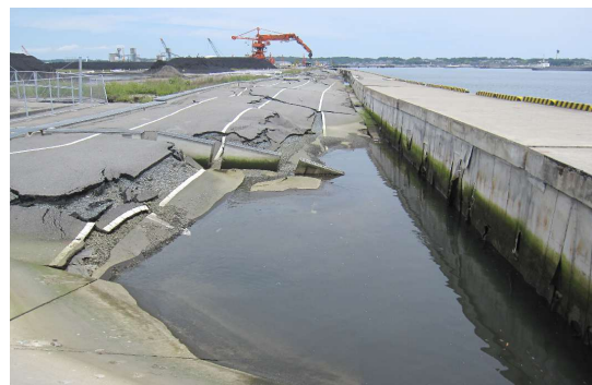
写真 3.3.27 小名浜港の被災状況(6) (第5、6埠頭、ケーソン背面の陥没)
