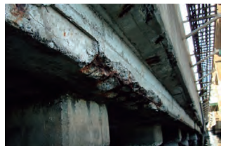
■海水面に近いため日常の維持管理が困難であり、コンクリート剥離から鉄筋露出などの損傷が発生
