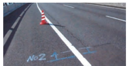
■路面ひび割れなど損傷が発生する鮫洲埋立部
