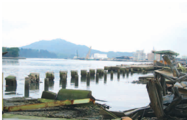
写真2.2.6 気仙沼漁港；栈橋上部工の流出
