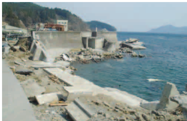
写真2.2.2 大船渡市三陸町の防潮堤被害*
