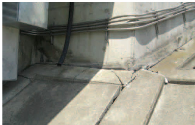
写真2.1.5 橋台法面のひびわれ
