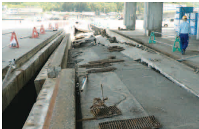
写真2.2.5 久慈漁港；渡版落下・背面陥没
