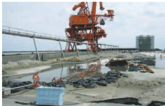
写真2.2.9 小名浜港第3埠頭：岸壁背面の液状化
