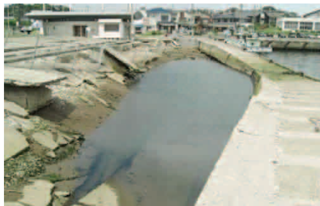
写真2.2.10 那珂湊漁港：鋼矢板岸壁のはらみ出し
