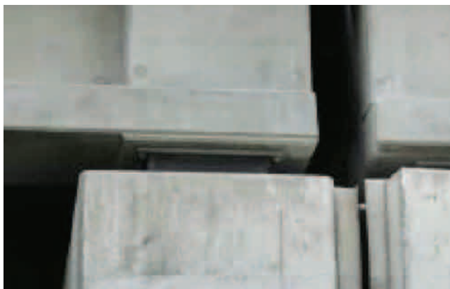
写真2.1.4 支承部の変形
