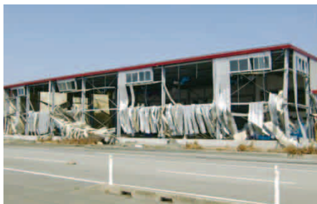
写真2.2.4 石巻漁港の工場被害*
