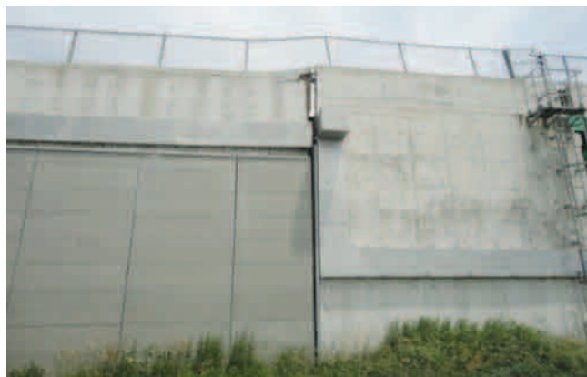
写真2.1.6 桁端部でのずれ
