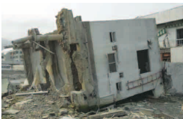
写真2.3.1 津波により転倒したRC造建物
