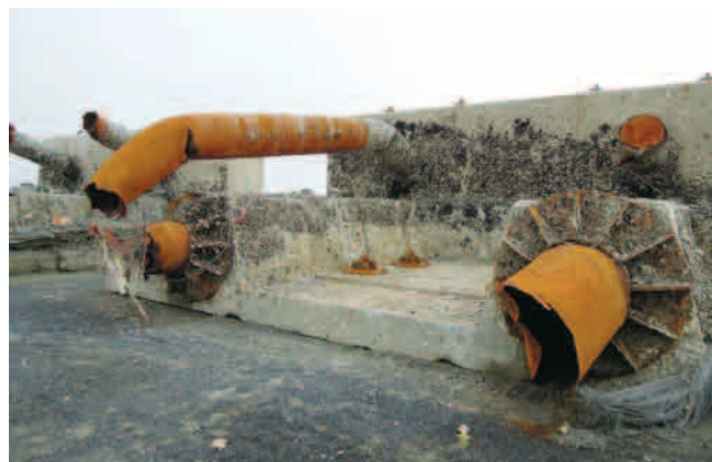
写真2.2.7 石巻漁港：波除堤の鋼管杭破断状況
