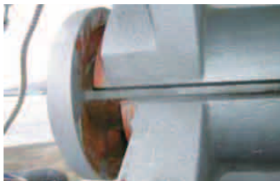
上沓と下沓でズレを生じたP3橋脚
