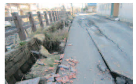
震災直後 護岸損壊の状況
