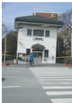
写真2.3.3 液状化被害②*
