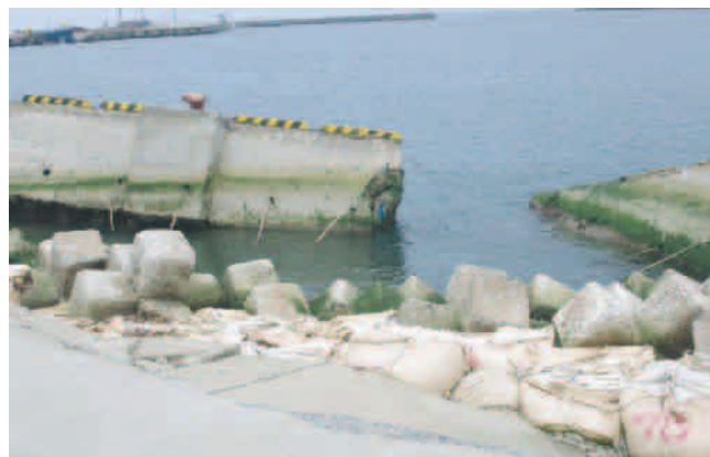
写真2.2.8 相馬港1号埠頭：直線部の破損・洗掘
