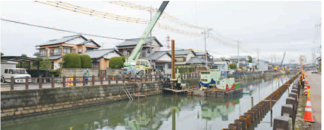
周辺住宅地にも液状化による大きな被害が発生した小野川流域
