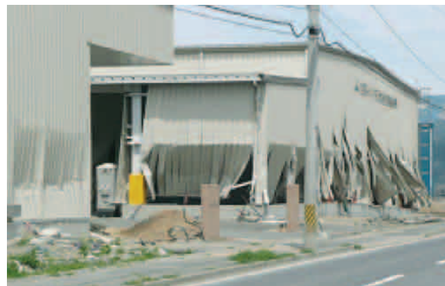
写真2.3.9 近接構造物の被害状況
